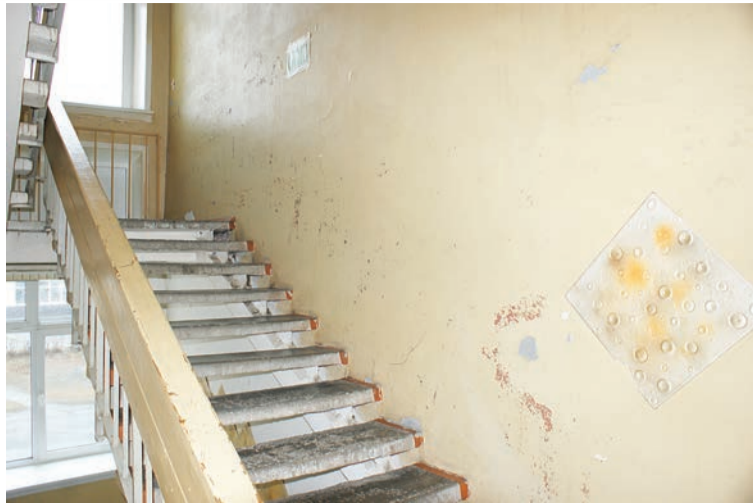
Лестничные марши требуют ремонта
