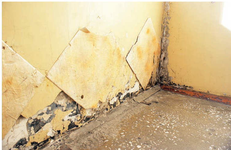
Здание КБО разрушается от сырости
