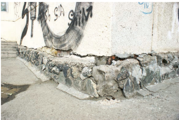
Облицовка фасада отходит от стен
