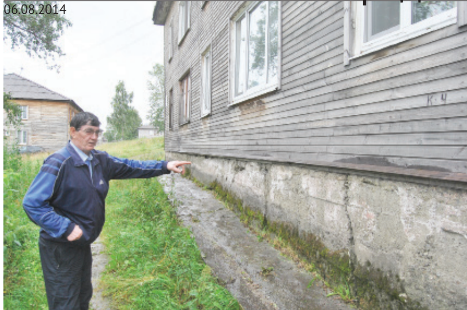
Николай Ильдебаев посчитал, сколько трещин в фундаменте их старой деревяшки
