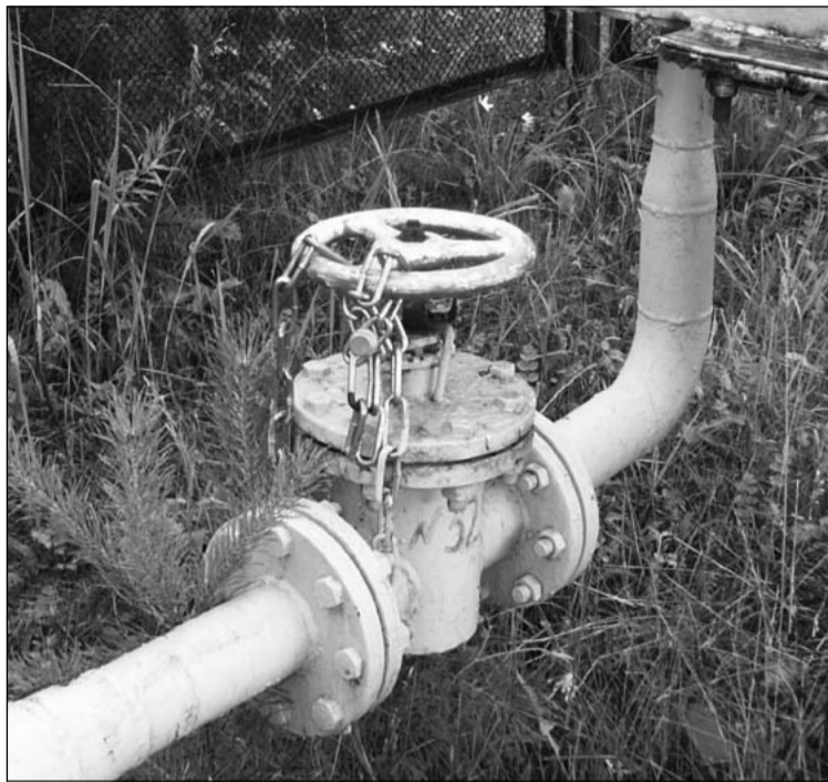
Газовый вентиль на замке
