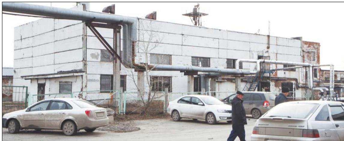
Котельная № 5 – объект, приносящий УЖКХ самые большие убытки
