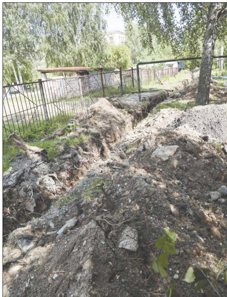
По этой траншее, обезобразившей двор многоквартирного дома № 9 по улице Карла Маркса, МУП «Горсети» протянули кабель к двухквартирной избушке госпожи Филимоновой
