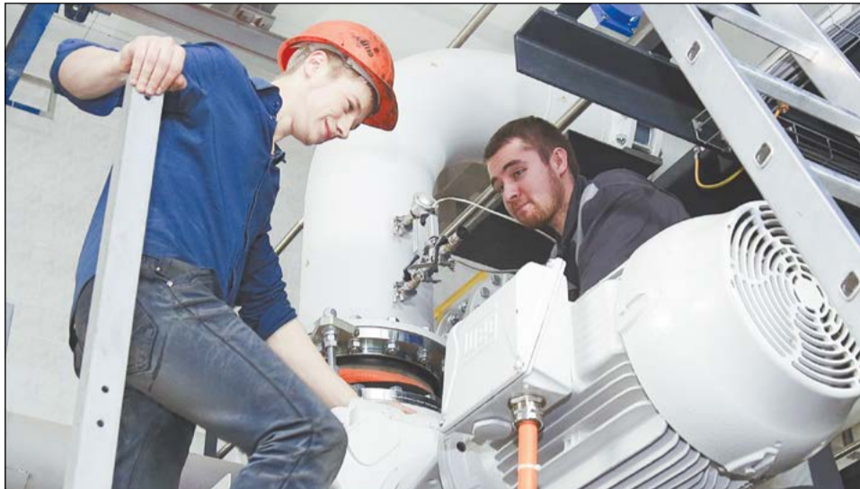
Насосная станция новых гарнисажек готова к пуску второй печи
