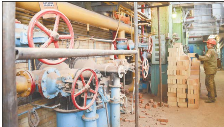
В котельной № 2 пыль повсюду
