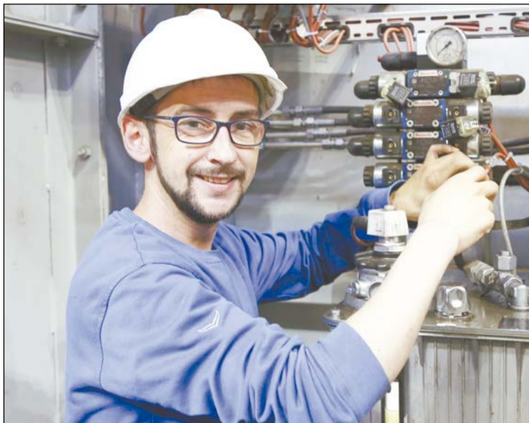
Вся электрическая начинка новой печи – зона ответственности Маркуса Шнайдера
