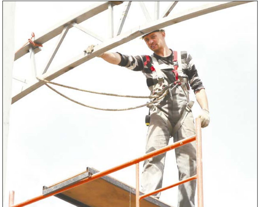
Сборка навеса идёт по накатанным рельсам, ведь это уже третий подобный объект на ВСМПО
