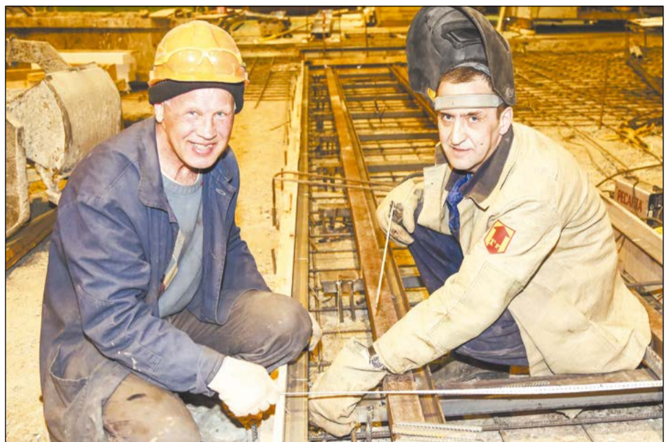
Электрогазосварщик Евгений Углов и бригадир монтажников Геннадий Бахтин монтируют арматуру для очередного фундамента
