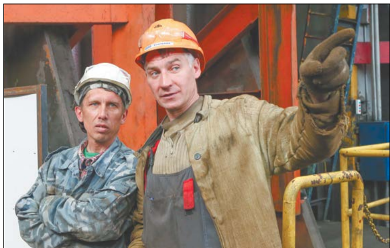
Монтажник предприятия «Сталькон» Дмитрий Батухин и сварщик Сергей Порцев уточняют порядок работы
