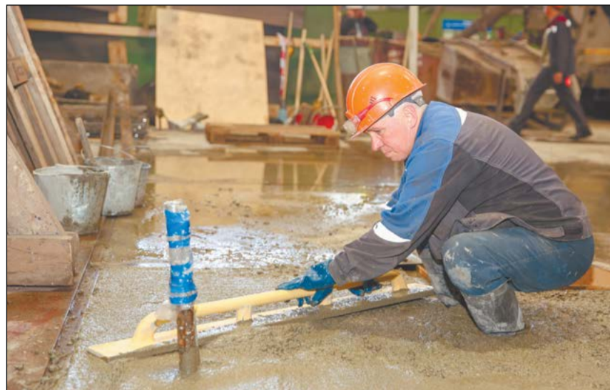
Бетонщик Александр Иванов знает: бетон надо не просто принять, но и разровнять хорошенько
