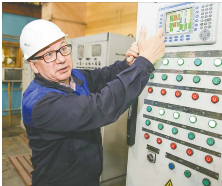
Игорь Кокшаров контролирует работу насосно-аккумуляторной станции
