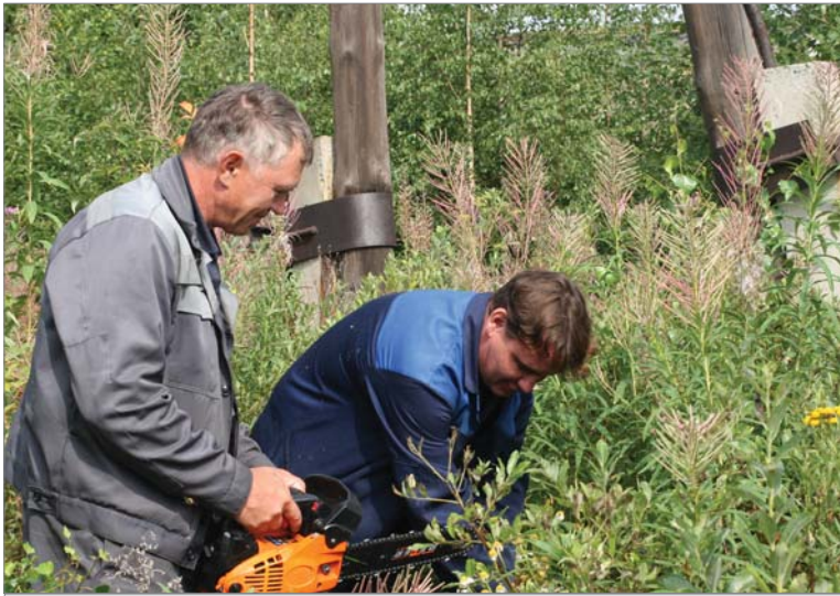
Электромонтёры-линейщики Андрей Лосицкий и Сергей Ананьин очищают трассу воздушной линии от травы и деревьев.
