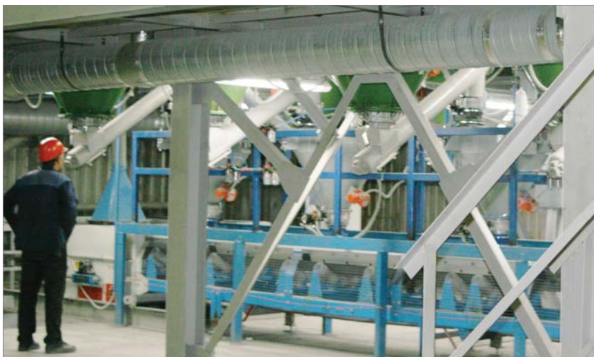
Новая линия дозирования лётчных масс обеспечивает более высокую производительность.
