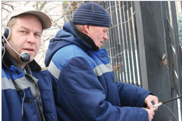
Электромонтёры Фёдор Мальцев и Максим Утюмов ставят муфту на повреждённый от воды телефонный кабель между центральной проходной и заводоуправлением.
