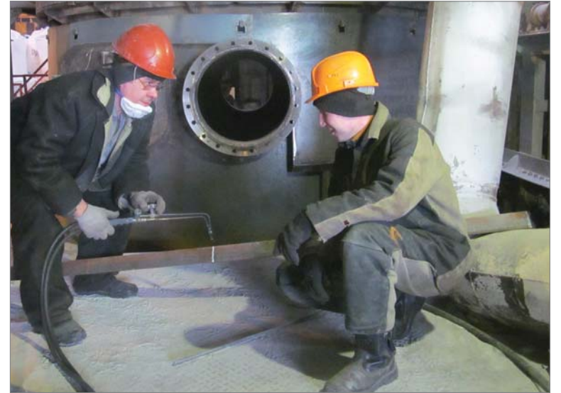
На монтаже печи много работы у сварщиков РСУ Василия Мишкина и Евгения Хромцова.
