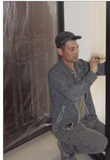
Тимур Калимуллин проверяет, как работают дверные замки.
