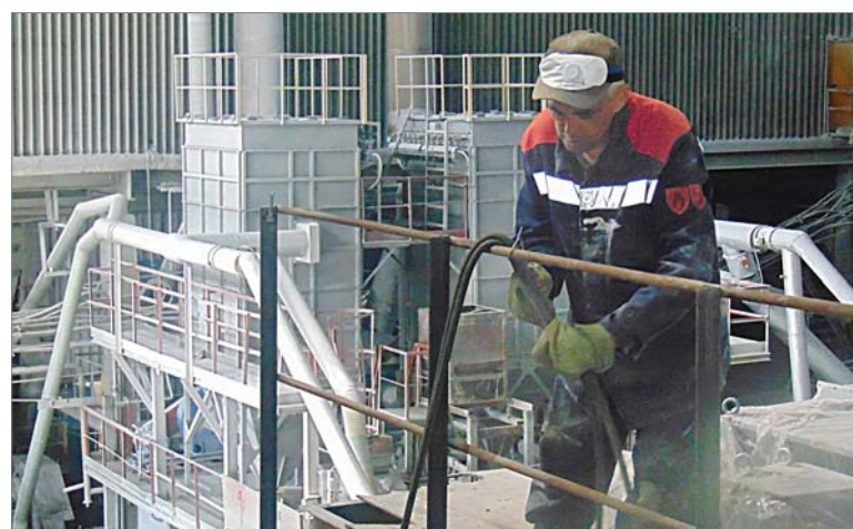
В цехах монтируются современные аспирационные установки.
