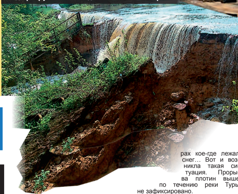
Вода разрушила часть дамбы в 51-ом квартале.
