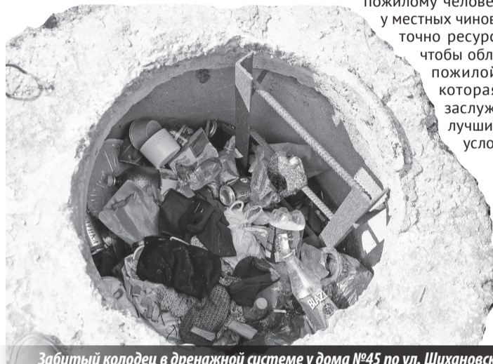
Забитый колодец в дренажной системе у дома №45 по ул. Шихановской, г. Н. Тура
