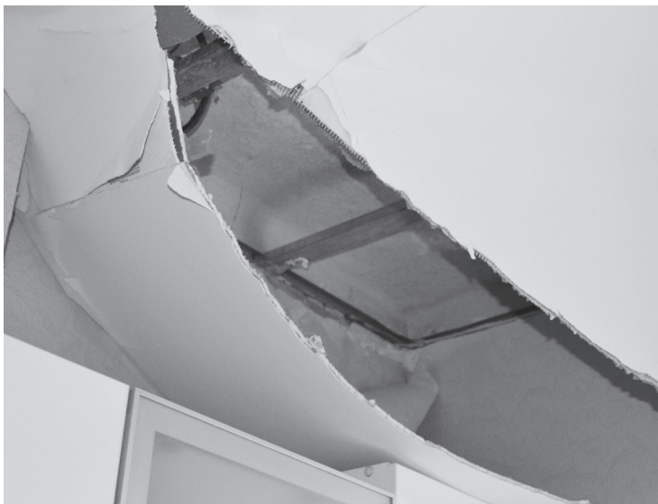
Так выглядит потолок в восьмой квартире дома № 17 по ул. 40 лет Октября. ФОТО АВТОРА
