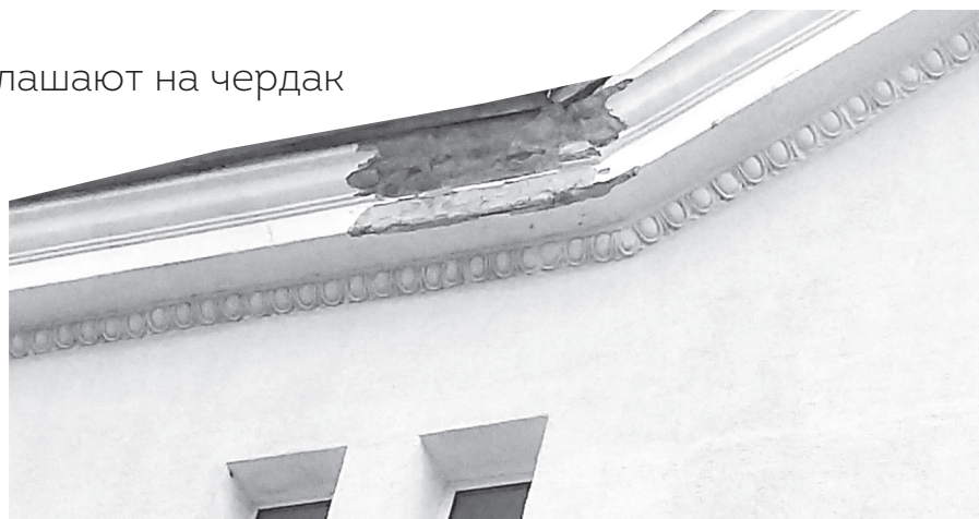
И фасад у дома 18 по улице Пушкина в Лесном «аварийный». ФОТО АВТОРА
