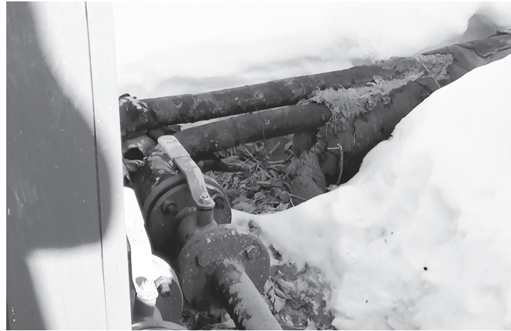
Уличные теплосети, Коммунистический проспект, 1. ФОТО АВТОРА
