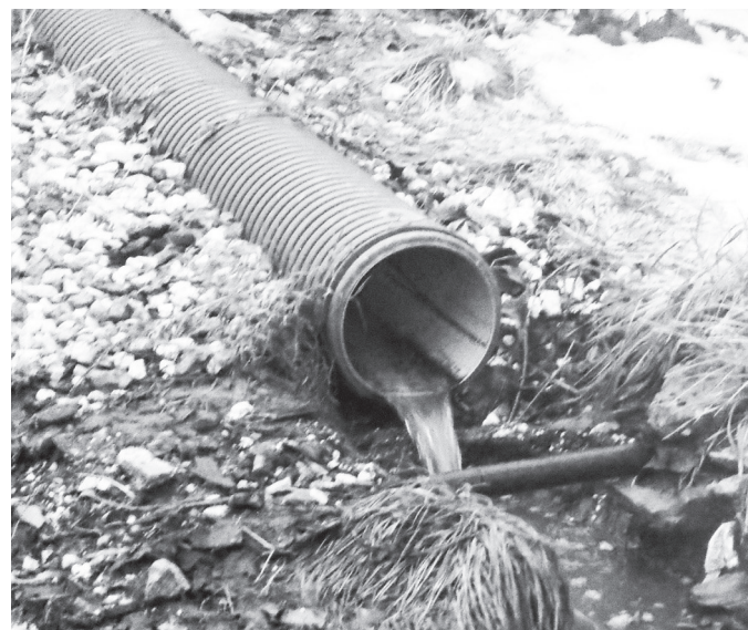
С помощью дренажных труб владельцы участков пытаются отвести воду от своих домов
