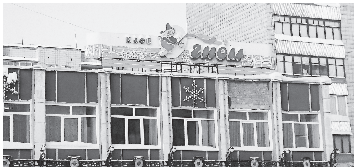
Поврежденный фасад кафе «Гном». ФОТО ОЧЕВИДЦЕВ
