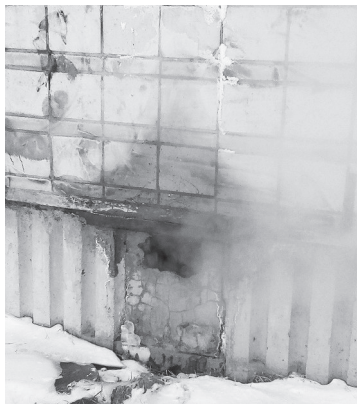
Нижняя Тура, Говорова, 8, из подвальных отдушин идёт пар, разрушая стены дома
