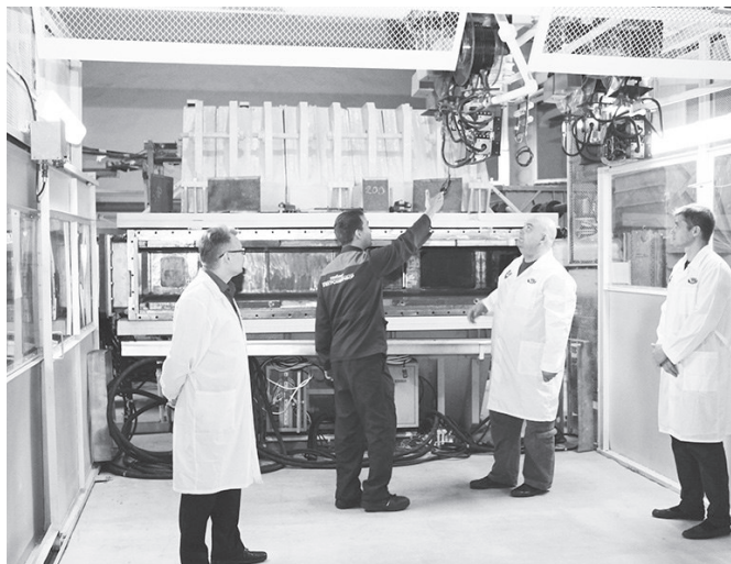
Проверка высоковольтного оборудования второго контура
