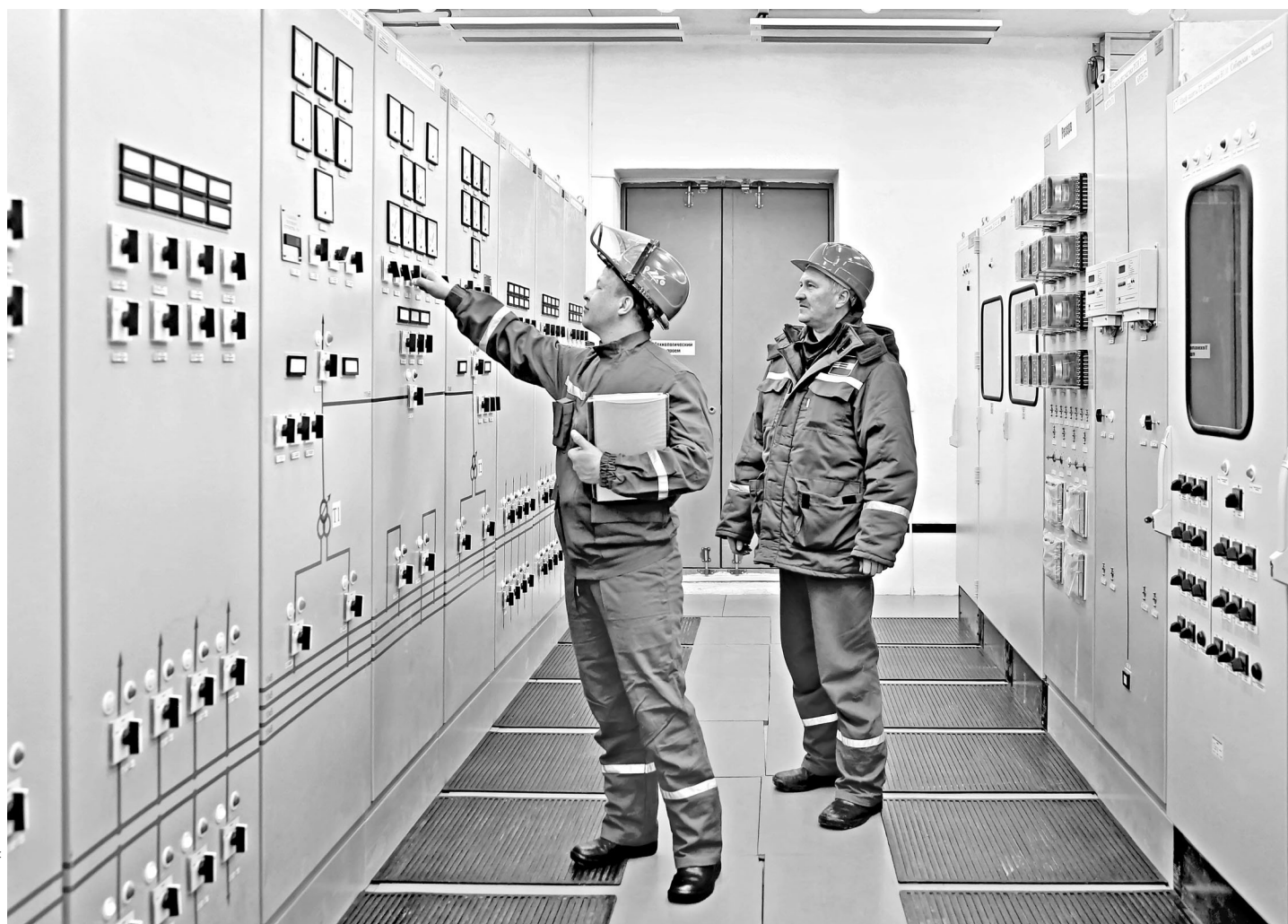
В Екатеринбурге введена в работу подстанция «Спортивная», получившая имя в честь зимней Олимпиады в Сочи. Новый энергообъект, расположенный в районе активной жилой застройки, повысит надежность электроснабжения потребителей и значительно увеличит возможность подключения многоквартирных домов, предприятий малого и среднего бизнеса. Общая заявленная мощность объектов, присоединяемых к подстанции, превышает 21 мегаватт. По словам генерального директора ОАО «МРСК Урала» Валерия Родина, «Спортивная» оснащена самым современным оборудованием, в частности, автоматическими системами дистанционного управления и защиты. Инвестиции компании в проект составили 347 миллионов рублей.
