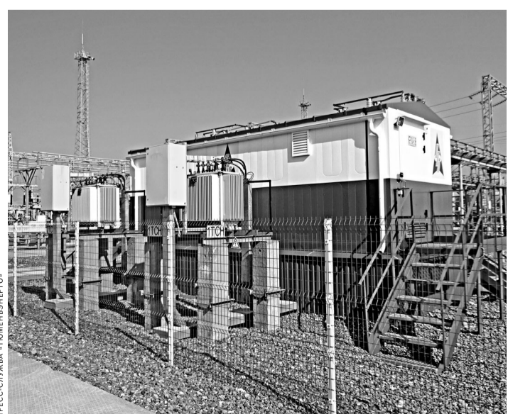
Новая подстанция «Соровская» обеспечит надежное энергоснабжение потребителей, в том числе нефтедобывающих компаний.
