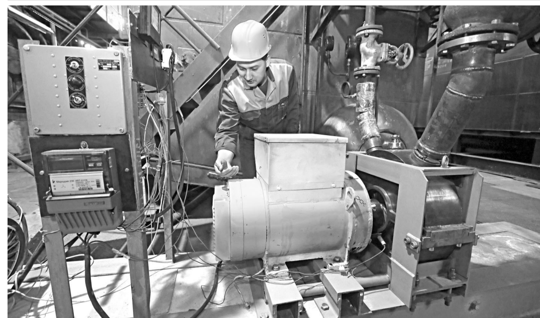
Установка, по словам директора Уральского энергетического института УрФУ Сергея Сарапулова, позволяет утилизировать избыточный водяной пар, вырабатываемый котельными, получая дополнительную энергию. При этом имеет высокие показатели по выдаваемой мощности на единицу массы: турбина весом 450 килограммов может выдавать 30 киловатт. (Например, для отопления дома площадью 300 квадратных метров требуется мощность 15–20 киловатт.) Руководитель компании-разработчика Сергей Перминов сообщил, что конструкция отличается уникально малыми размерами, а также отсутствием редуктора и масляных ванн, что позволяет использовать ее в любом помещении. Кроме того, стоимость турбины в полтора раза ниже изделий аналогичной мощности.
