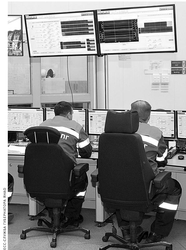
Завод по сжижению газа на Ямале оснащен самым современным оборудованием и системой управления.
