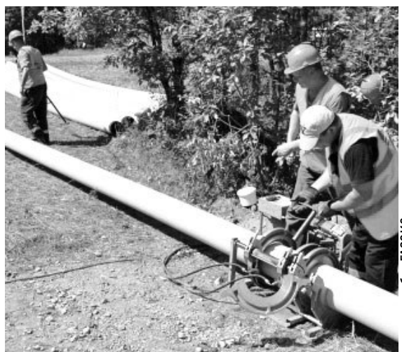
Методом реновации в этом году под Курганово заменят 1,5 километра газопроводов высокого давления. Если эксперимент признают удачным, его распространят на другие территории.
