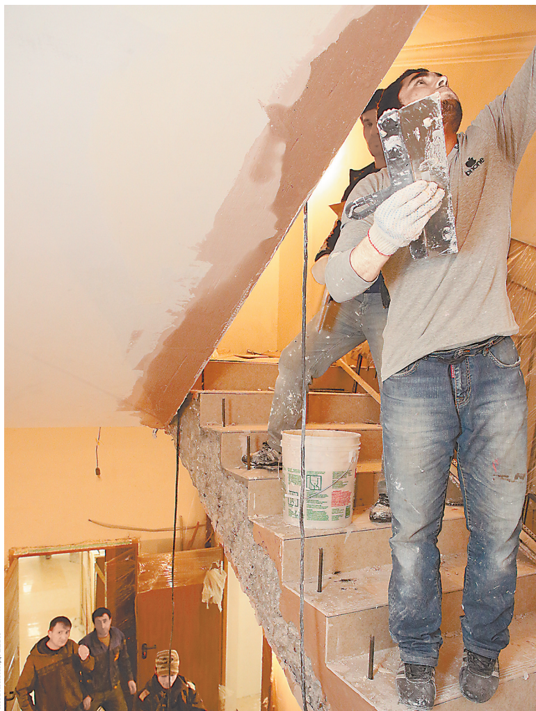
В некоторых домах придется заменять целые лестничные пролеты.
