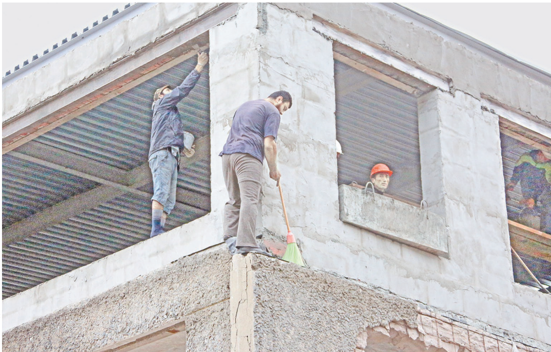
В 2014 году специалисты трудовой инспекции зафиксировали 1629 нарушений правил техники безопасности (всего выявлено 16 059 нарушений).
