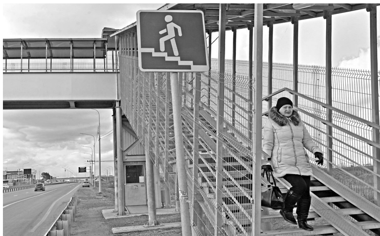
Конструкции перехода в поселке Яр ненадежные: плоская крыша от осадков плохо защищает, сквозь металлические решетки сильным степным ветром несет то дождь, то снег.
