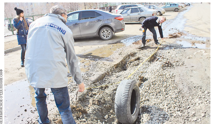
Дорожники не потрудились восстановить асфальтовое покрытие после ремонта инженерных сетей.
