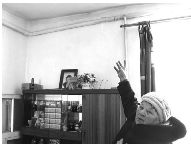
Ольга Купцова показывает подтеки на потолке после ремонта кровли
