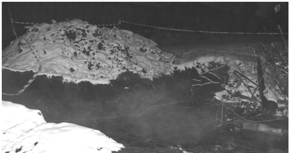
Прорыв теплотрассы по ул. Республики - 8 Марта
