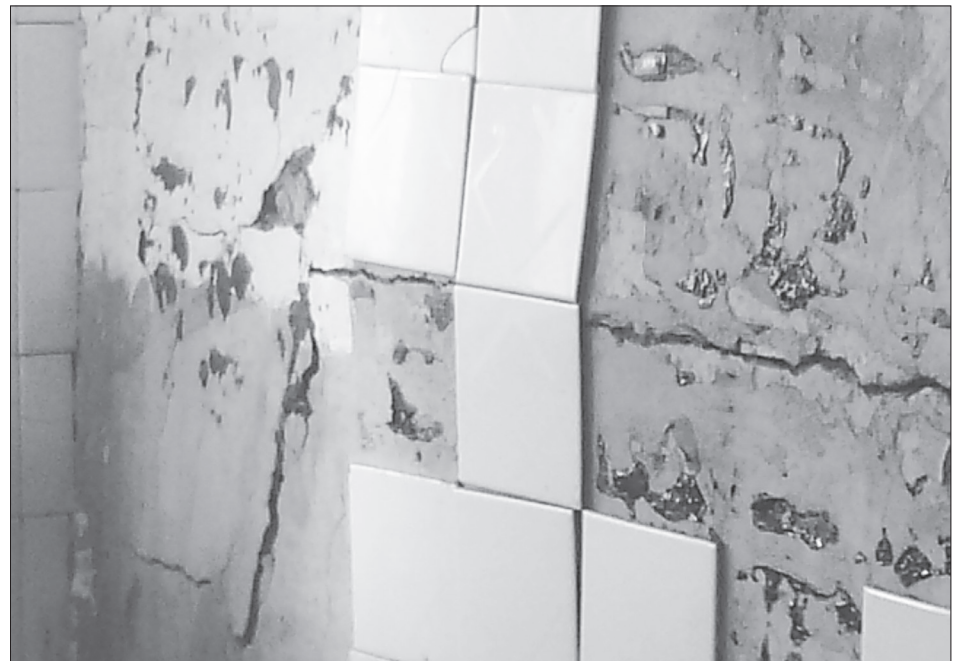
Стена в одной из квартир выгнулась дугой
