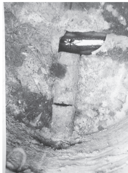
Трещины в трубах канализации видны невооруженным глазом
