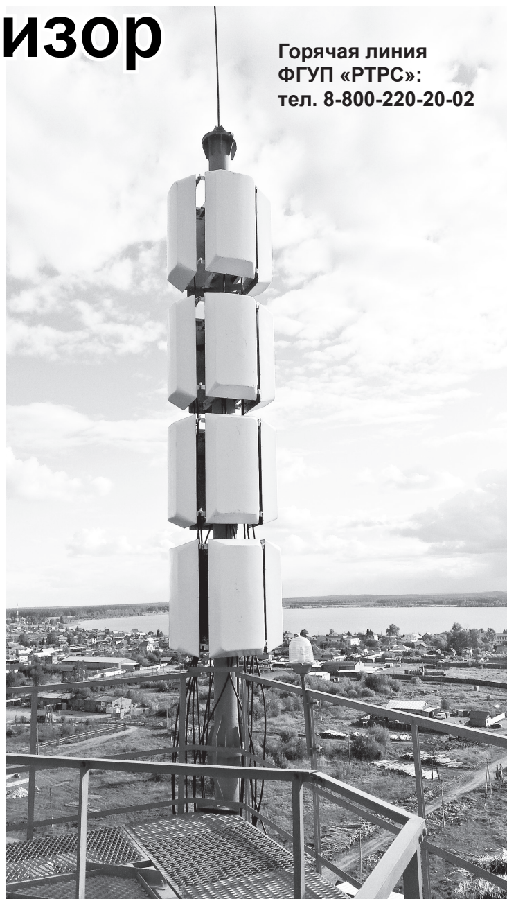
Передающая антенна первого мультиплекса (РТРС-1) на станции цифрового вещания в селе Щелкун
