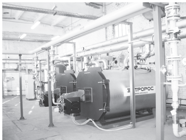
Новые котлы дают больше тепла
