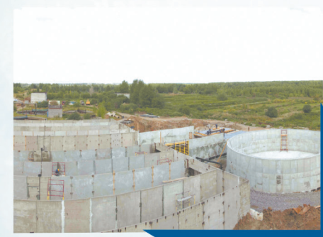
Биологические очистные сооружения будут сданы в эксплуатацию в 2011 году и станут гарантом экологической безопасности Нижнего Тагила.
