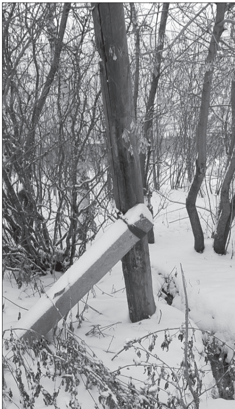
Деревянная опора растрескалась.
