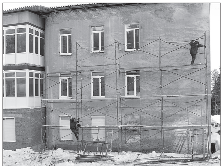
Это здание официально не относится к «Аисту», но примыкает к СДЮШОР и портит общий вид комплекса. К началу Кубка фасад приведут в порядок.
