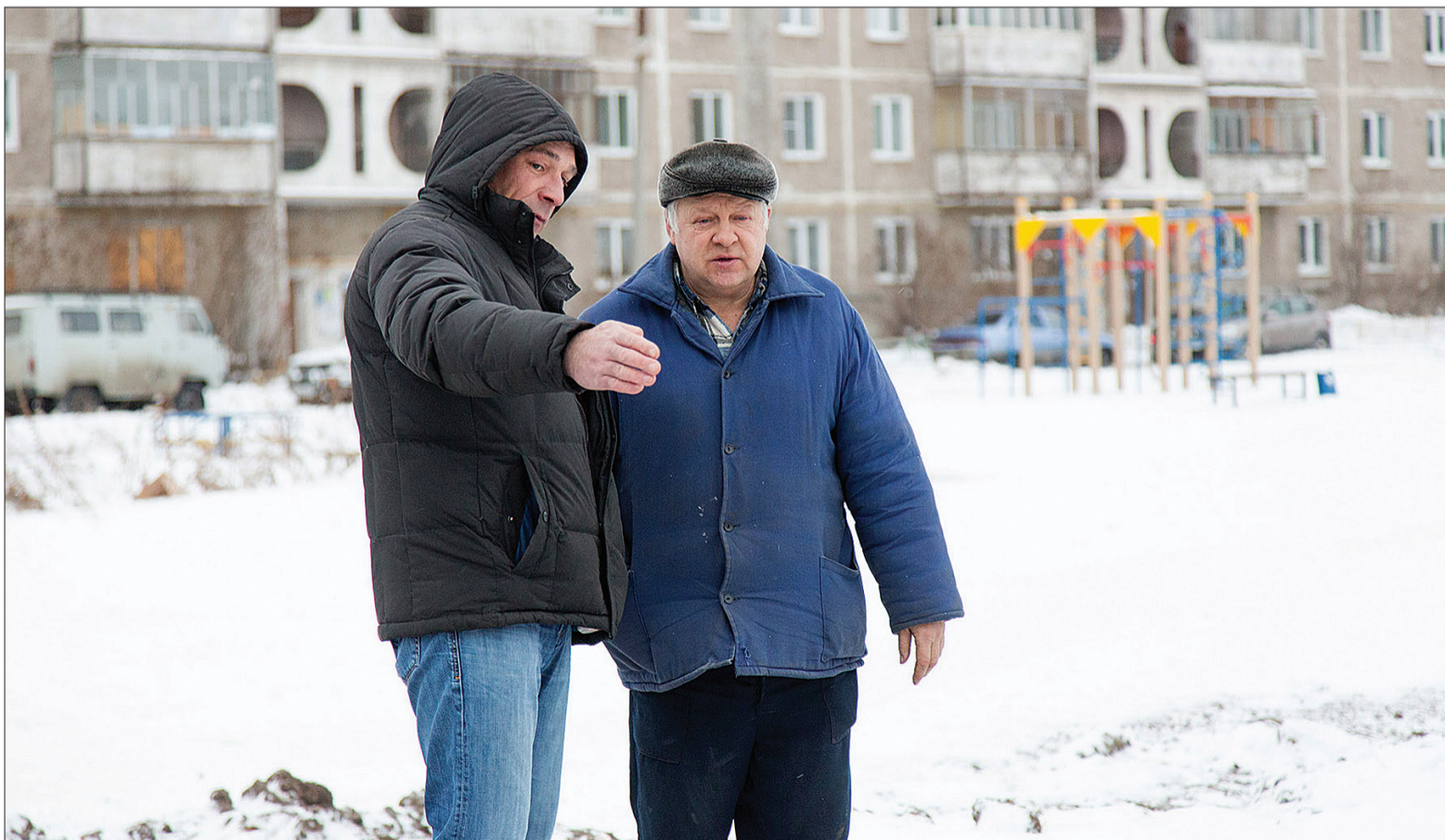
На месте аварии главный инженер Горэнерго Андрей Тюлькин и хозяин автомойки Виктор Косарев, который не понимает, что он сделал не так. «Давайте мы снова раскопаем трассу бульдозером и покажем, где вы врезали свою канализацию!» - предлагает инженер.
