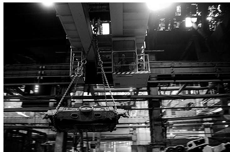
Новый электромостовой кран.
