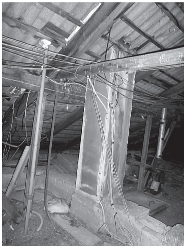
Чердак в проводах.
