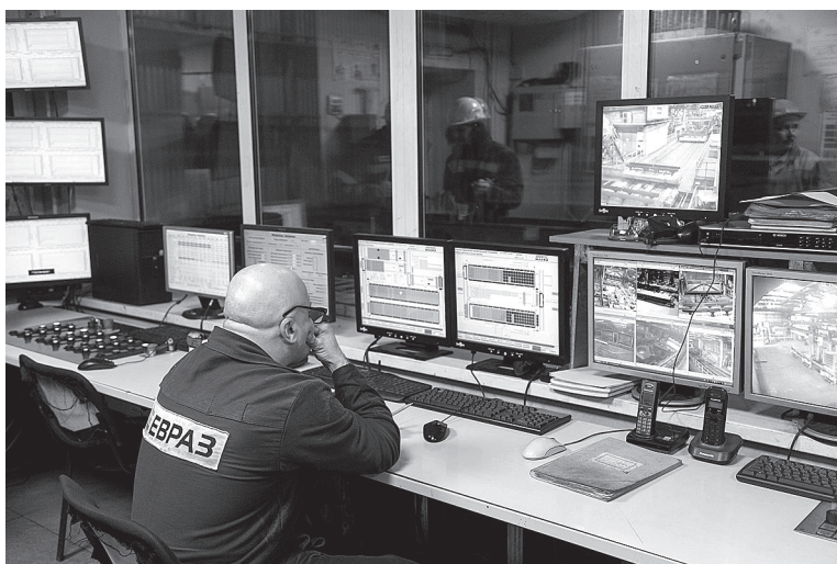
Главный пост управления.
