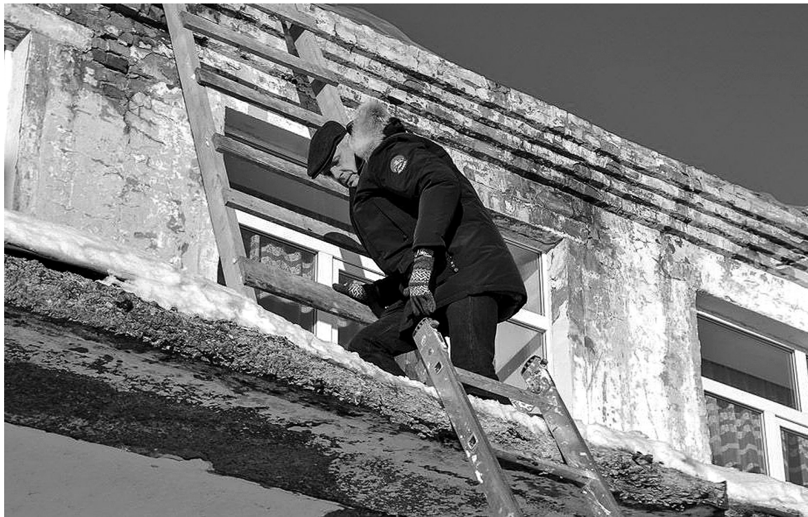
Сергей Носов решил убедиться своими глазами в качестве ремонта кровли на школе.
